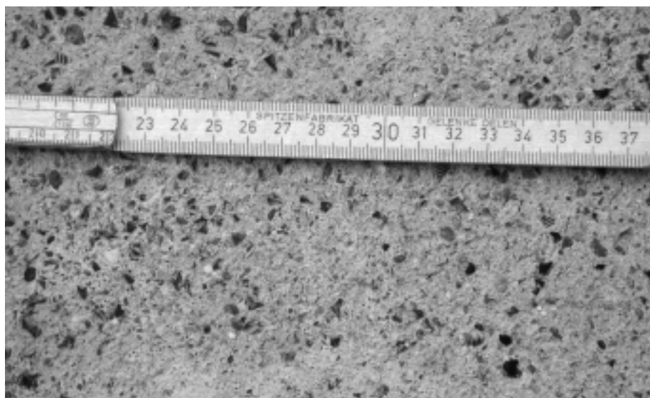
Fig. 7: Granulé en caoutchouc intégré dans la couche de béton supérieure: pour réduire l'usure, la technique d'évacuation du fumier doit pouvoir être utilisée de manière à ménager le revêtement.
