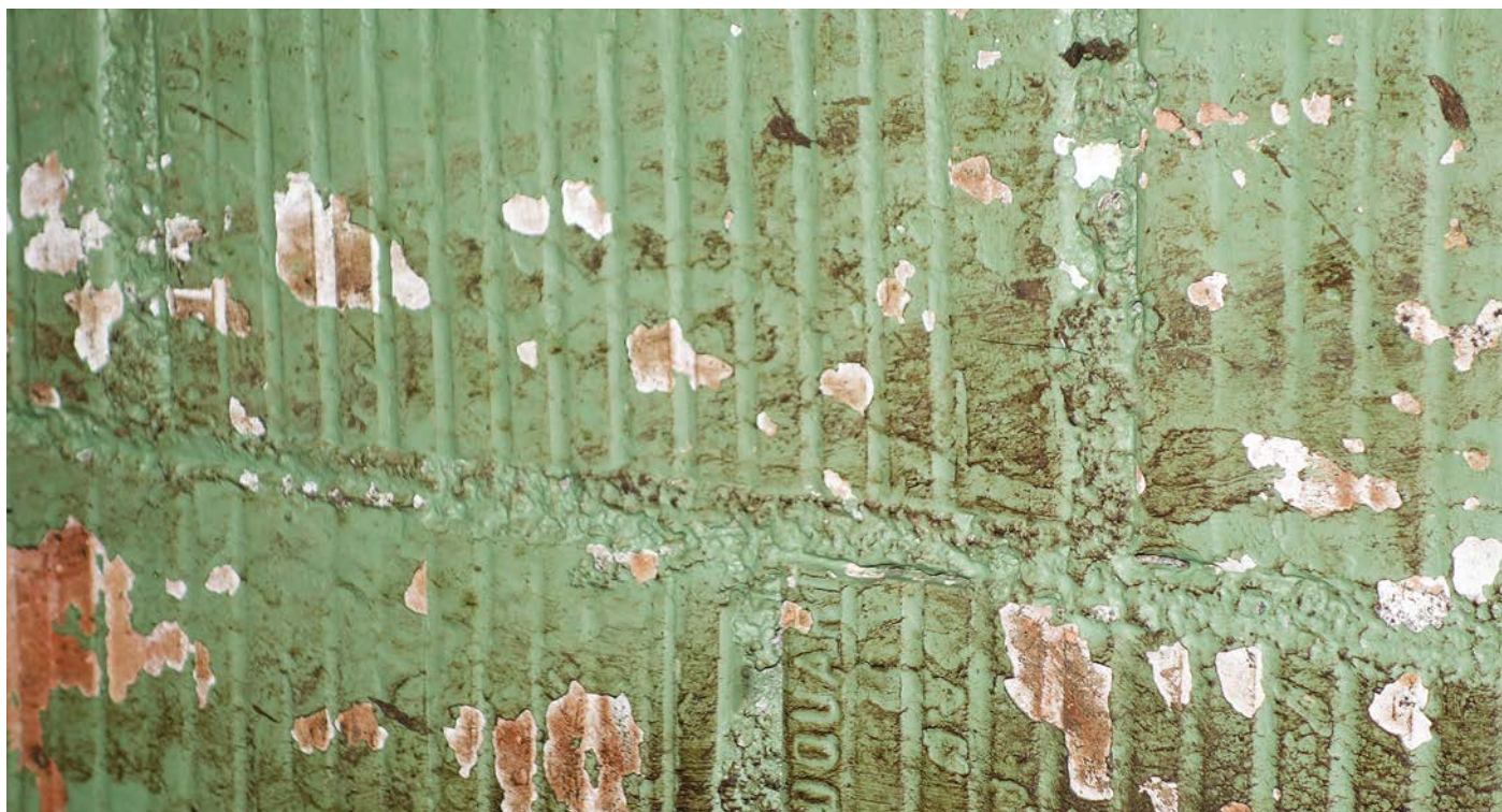
Exemple de peinture contenant des PCB. Photo : EMPA.
