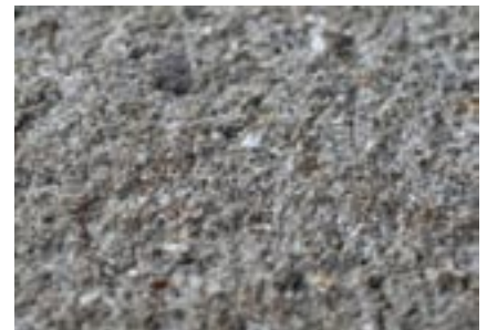
Fig. 9: Procédé d'assainissement: jet d'eau haute pression avec abrasifs fins 0,6–1 mm; ce n'est qu'une fois toutes les couches de calcaire décollées que l'on peut obtenir le caractère antidérapant nécessaire.
