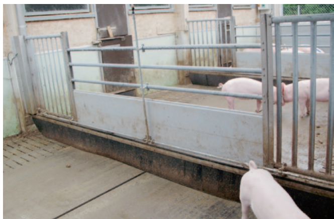
Fig. 11: Double bavette en caoutchouc sous la séparation des boxes pour empêcher les porcs de se glisser dessous.
