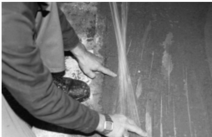
Abb. 8: Der Zeitpunkt für das Profilieren von Frischbeton wird mit der Fingerprobe bestimmt. Je nach Anliefer- und Einbringbedingungen kann dies stark variieren.
