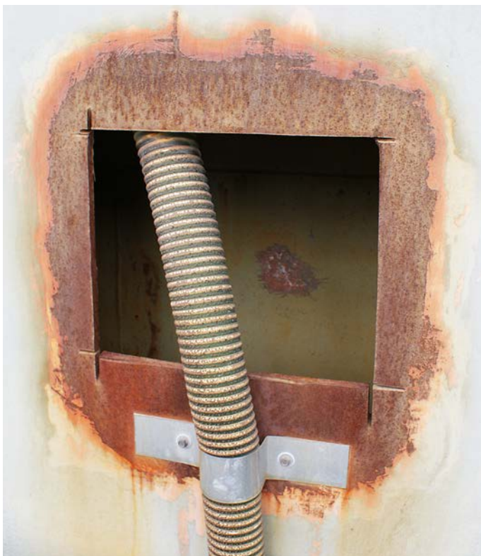
Beispiel von PCB-haltigem Korrosionsschutzmittel. Bild: EMPA.
